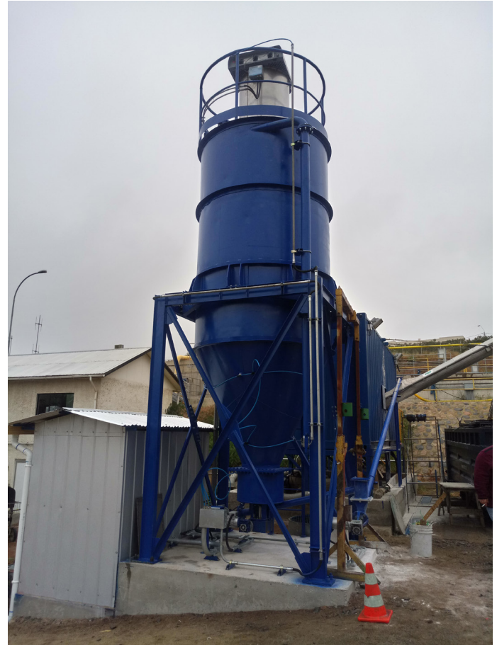
Diseño, fabricación y montaje de Sistema Encalado para Papudo. Cliente: ESVAL S.A.
