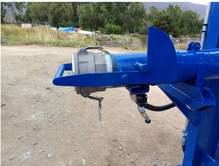
Sistema de control de carga de cal a través de un limit switch.
